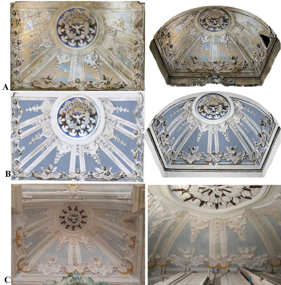
Figura 1. A. Rilevamento tridimensionale del catino absidale prima degli interventi. B. Simulazione dell'intervento durante i lavori. C. Intervento concluso.
